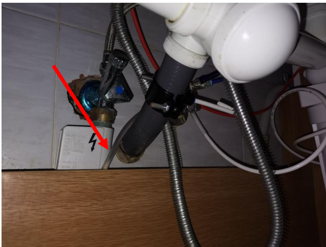
Conducto de desagüe hacia el patio por detrás del mobiliario.
