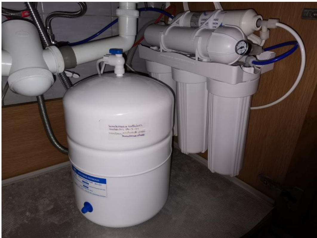
Nuevo equipo de osmosis más moderno.
