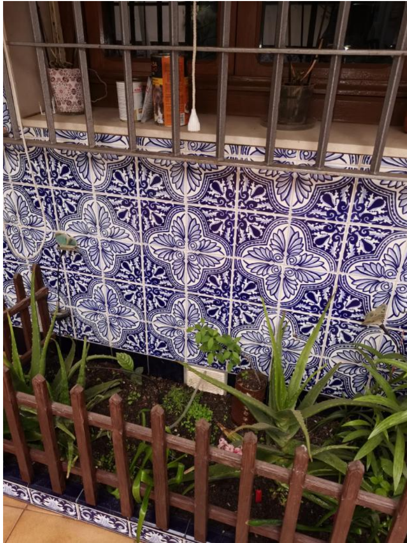
Salida del conducto mediante una rejilla de ventilación hasta el arriate.
